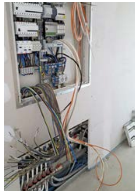
So sieht die Elektro- und AAL-Zentrale in den Wohnungen in der Beethovenstraße 24 aus
